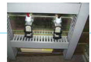
■ ボックス型変電所
